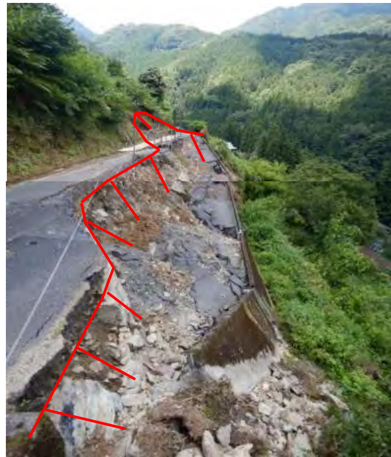
地すべり頭部を東側より臨む 市道の崩壊は延長約40.0mである
