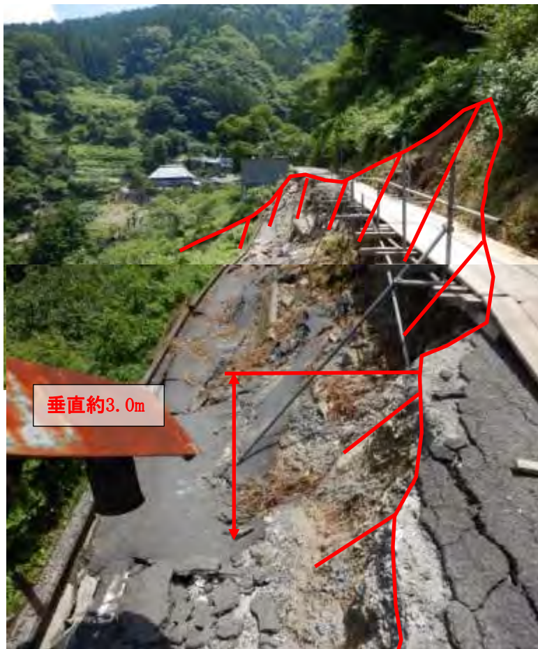
地すべりブロック頭部 地すべりにより頭部の市道が崩壊している
