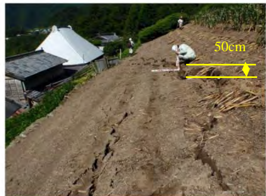
写真2 ブロック頭部の状況
