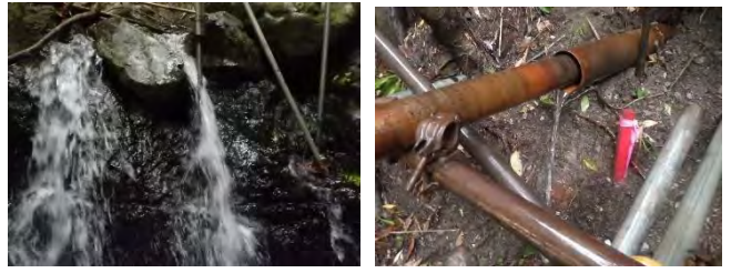
図 5-2 坑口付近の湧水・排水状況
