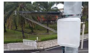
図4 設置したソーラーパネル
